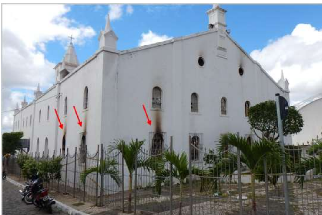
Figura 1. Marcas de queima na parte superior de três janelas (setas em vermelho), indicando a sala de origem do incêndio ( Fonte: Arquivo pessoal dos autores ).
